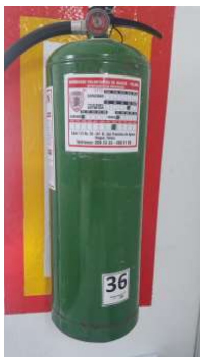
Ilustración 33. Extintor verde ubicado en Archivo
